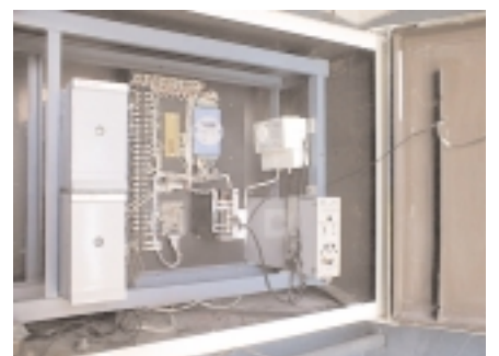
Рис. 5. Шкаф преобразователей и модуля ввода сигналов
