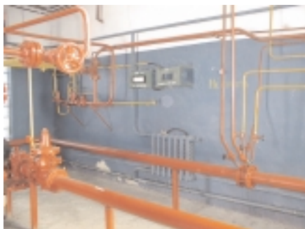
Рис. 1. Оборудование ГРП: трубки-отводы для датчиков
